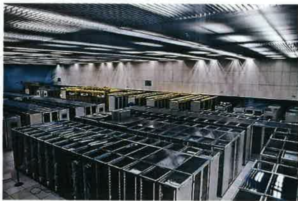
Beispiel eines Rechenzentrums (Quelle: wikipedia, dort CERN/Schweiz)
